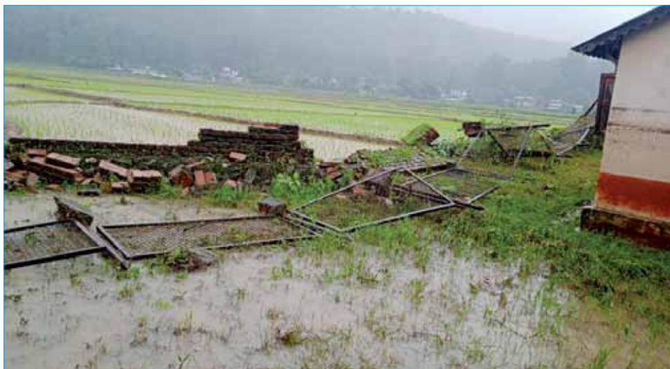
Het hek om het terrein van de school was helemaal weggespoeld.
